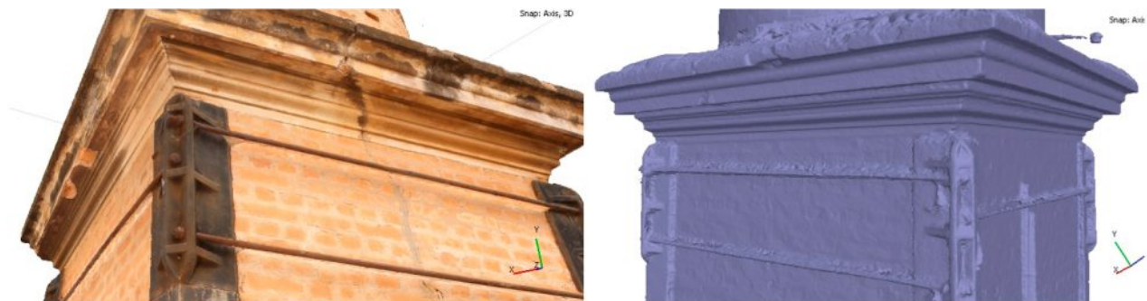
Fig. 13. Registro das perdas de argamassa sofrida na área da cimalha (fonte: Elaborado pelos autores).
