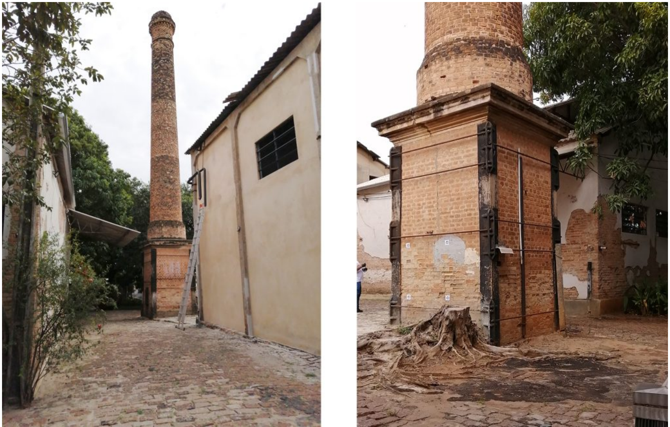
Fig. 2. Vista à distância e aproximada da chaminé - 2021 (fonte: acervo pessoal dos autores).
